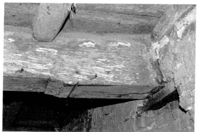
Afb. 18. Zuidvleugel, eerste verdieping. Het vaste sleutelstuk van moerbalk IIIIII [6] aan de noordzijde. Aan de andere zijde van de moerbalk bevindt zich een los sleutelstuk – vergelijk Afb. 86. Door optimaal gebruik te maken van de boom, wordt het rechter sleutelstuk uit het worteleind van een boom gekapt; het linker sleutelstuk wordt los toegevoegd.
