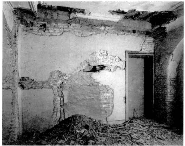
Afb. 15. Interieur van het poortgebouw met de sporen van een der zitnissen in de zijwand.
